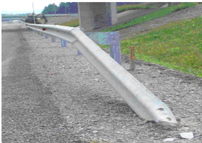
Slika 71: Napačno postavljen zaključni element ograje avtocesta Šentvid- Koseze
