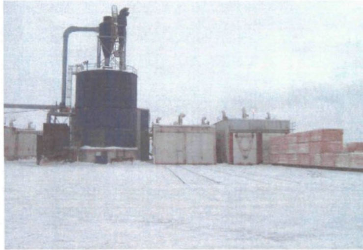
Figure 1.9: Séchoir industriel et centrale thermique
