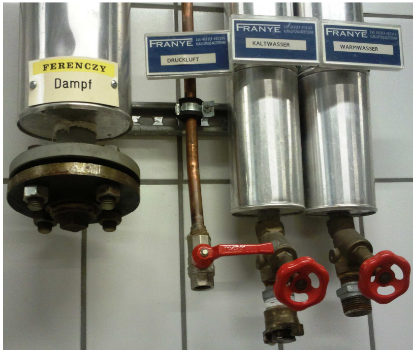
Abbildung 17: Zufuhrleitung für Dampf, Druckluft, Kalt- und Warmwasser
