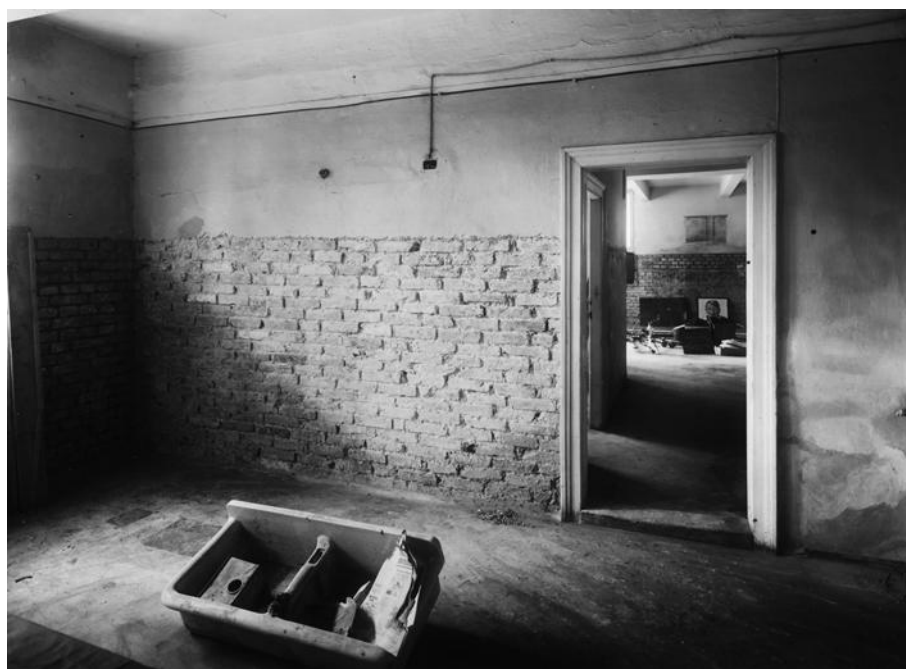
Abb.195: Zerstörtes HJ-Heim Wien 19., Peter Jordan-Straße 1942
