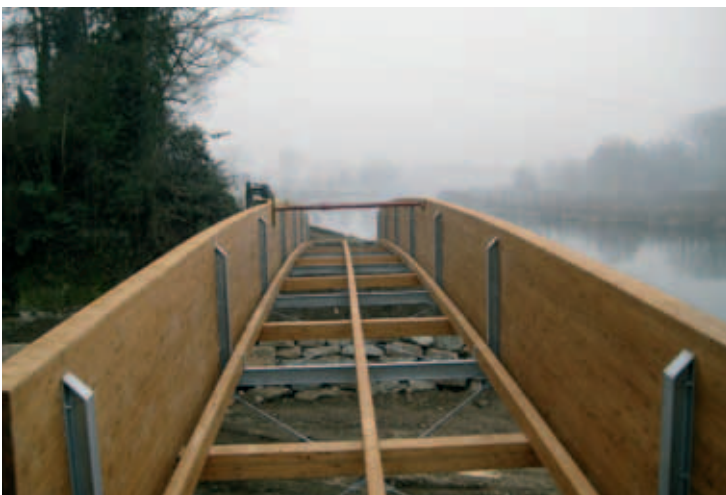
Il cantiere della passerella su Rio Costa Parisio fra Torino e San Mauro: l'opera che ha reso possibile il collegamento lungo il parco del Meisino sino a San Mauro sulla destra orografica del Po.
