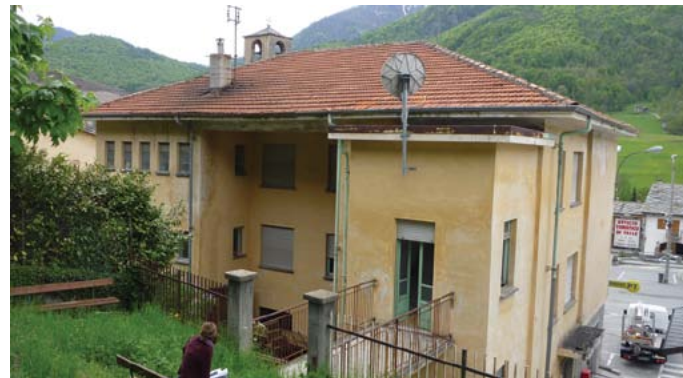
[Fig. 7 - foto dell'ex scuola di Sampeyre, vista da monte (nord-ovest) - foto Andrea Bocco]
