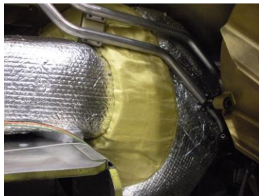
Figure 13. Fan Acoustic Blanket
