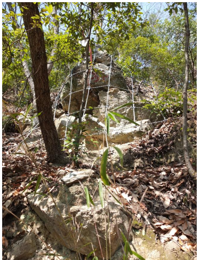
写真 13 急傾斜斜面の不安定な岩塊 ネットで保護されている。
