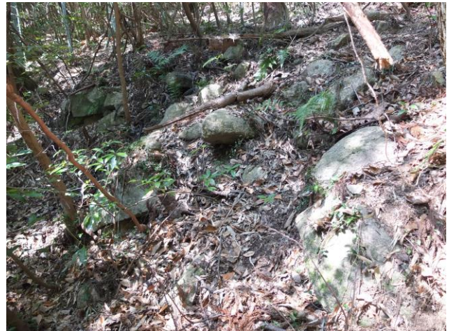
写真8 石垣 高さは約 1m。破損しており斜面がずれて変形している可能性がある。
