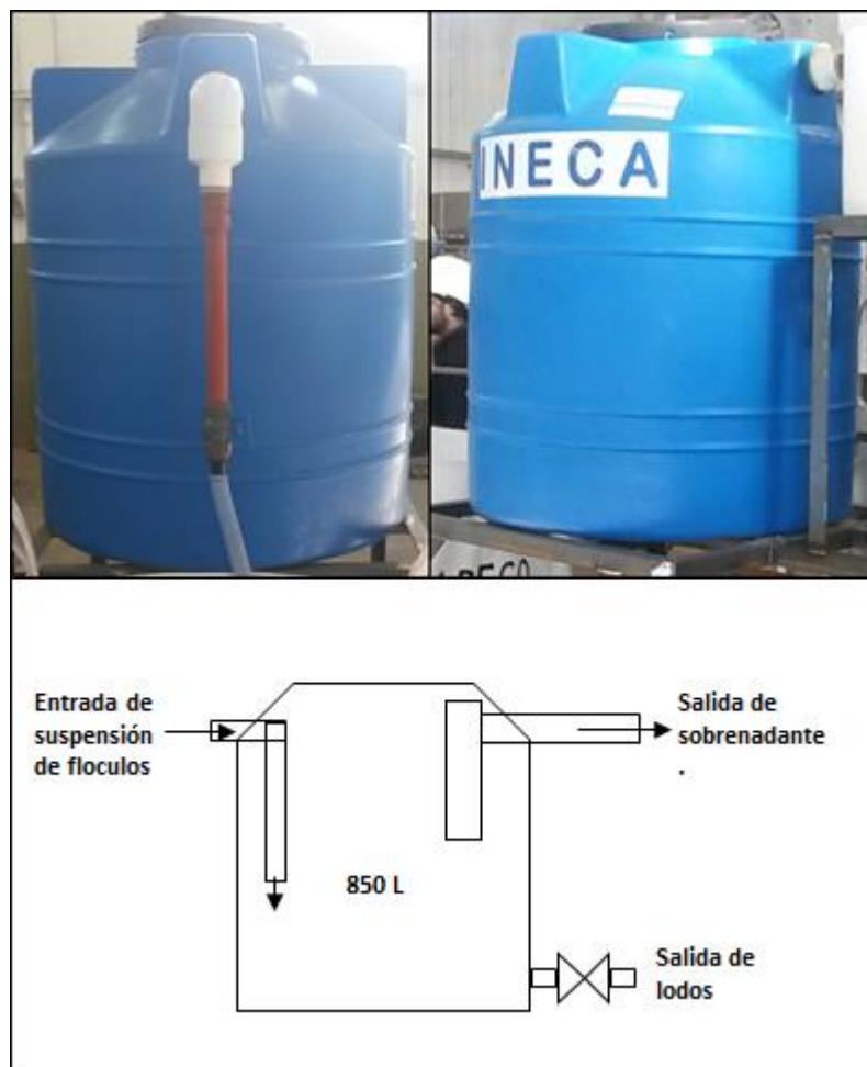
Figura 12. Tanque decantador estático convencional.
