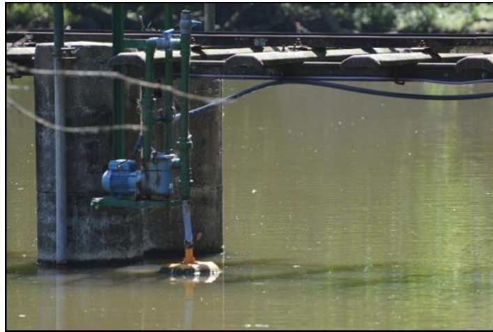
Figura 9. Bomba centrífuga para alimentación de SHR. El agua recorre 70 metros hasta llegar a la alimentación del sistema.
