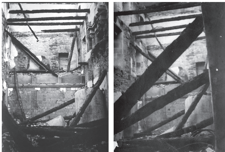
Figs. 2 y 3. Estado del interior de la licorería (planta baja), la cámara abacial (planta primera) y algunas de las celdas de juniore (planta segunda) tras el incendio, con todos sus forjados arrasados por la explosión, que se originó en alguno de los depósitos de la licorería que todavía se aprecian en ambas instantáneas. Fondo fotográfico del monasterio de Samos.
