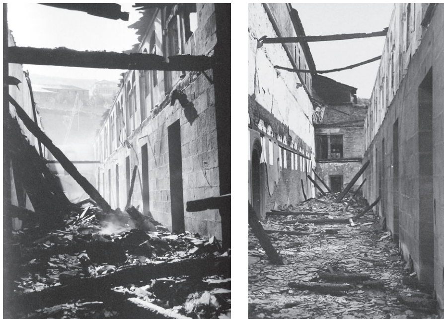
Fig. 17. Estado del interior de las galerías de los dos pisos superiores del ala noreste del claustro grande tras el incendio. Fondo fotográfico del monasterio de Samos.
