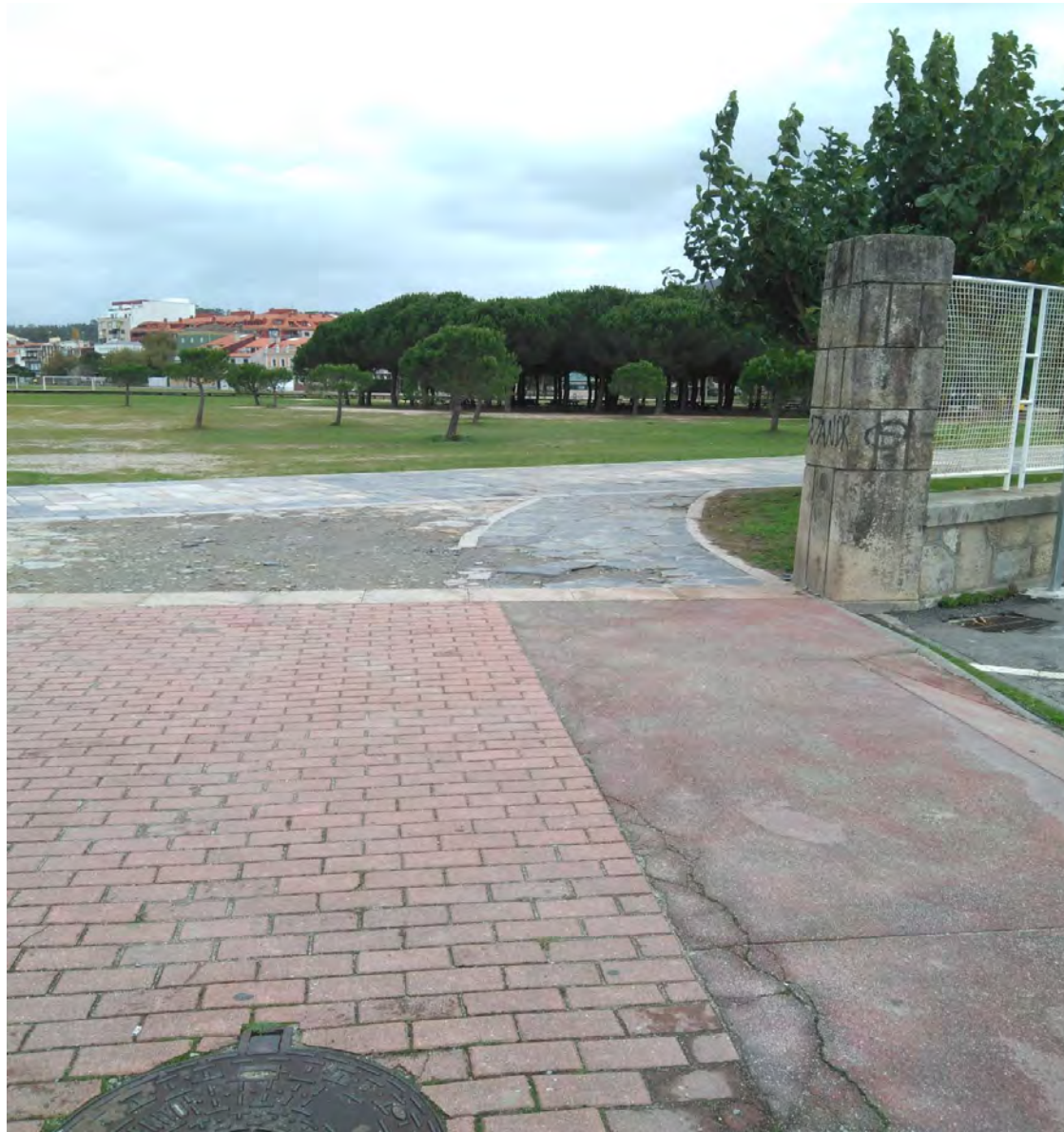
Imagen.4 Tramo de acera-bici en estado de deterioro
