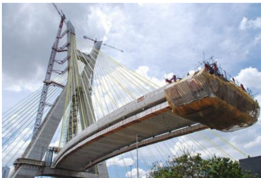
Figura 3.27 – Exemplo de construção por balanços sucessivos moldado in loco – Ponte Octavio Frias de Oliveira
