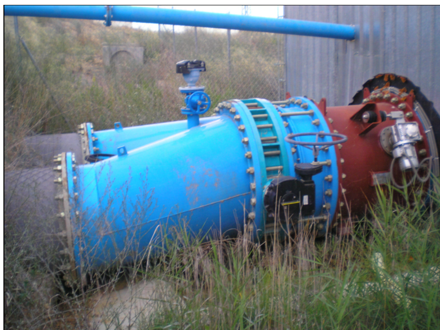
Fig. 33. Filtro después de balsa
