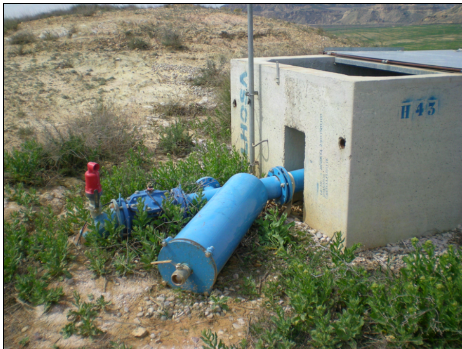
Fig. 39. Filtro y válvula del sistema de riego (hidrante 43)
