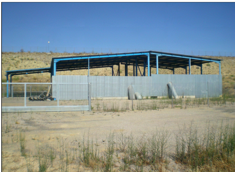
Fig. 34. Estación de bombeo
