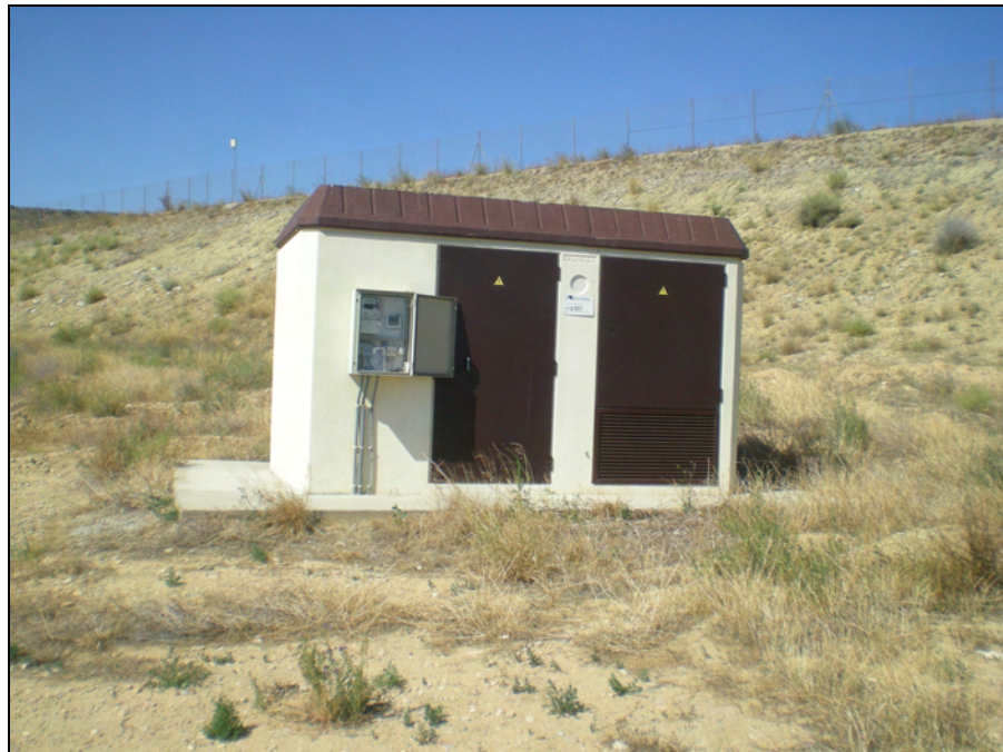
Fig. 37. Contador general de energía eléctrica
