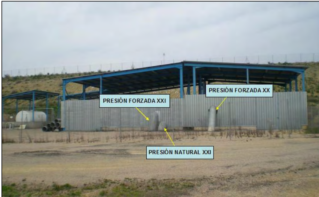
Fig. 7. Vista general de la estación de bombeo y las tuberías de impulsión de los diferentes sectores
