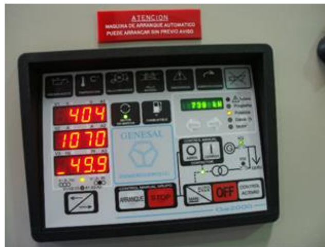
Figura 6. Cuadro de arranque Automático
