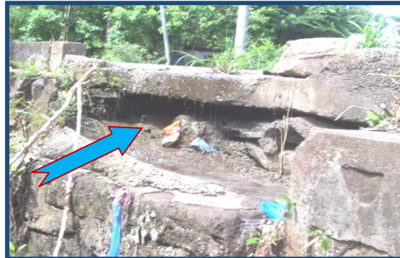
Foto N° 6: socavación en la carpeta de rodamiento Calle hacia la Modelo Fuente: Elaboración propia julio 2012
