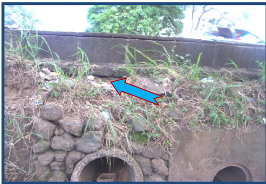
Foto N° 7: Socavación en alcantarilla de paso Frente al Cementerio Municipal de Tipitapa Fuente: Elaboración propia julio 2012
