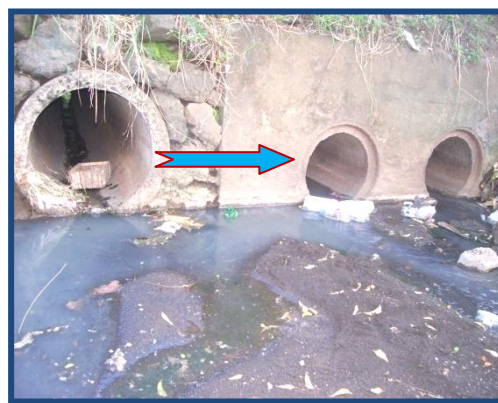
Foto N°11: Estructuras con distinto Ø de tubos En Barrio Ana Virginia Fuente: Elaboración propia julio 2012
