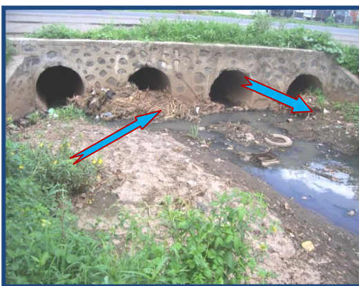
Foto N°12: Acumulación de sedimento en cabezal agua arribas, Carretera Panamericana,
