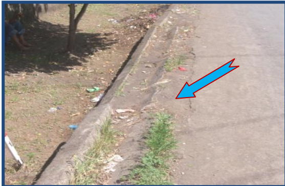
Foto N° 5: Cuneta en mal estado Calle hacia la Modelo Fuente: Elaboración propia julio 2012
