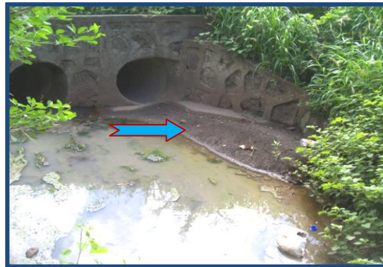
Foto N°9: sedimentación en aletones y cabezales Calle hacia la modelo Fuente: Elaboración propia julio 2012
