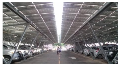
Imagen N°8: Estacionamiento solar, Centro de Convenciones Olof Palme, Fuente: Propia
