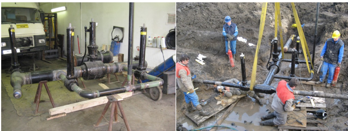
Obr. 10 a 11: Dílenským způsobem provedený ocelový svařenec VTL Armaturního uzlu (jakost mat. L245NE, L245ME) a jeho zabudování (foto autor)
