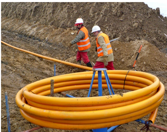
Obr. 15: Pokládka trubního materiálu PE 100 SDR 17,6 s ochranným pláštěm z PP (označení DUALTEC) odvíjením ze svitku [28]
