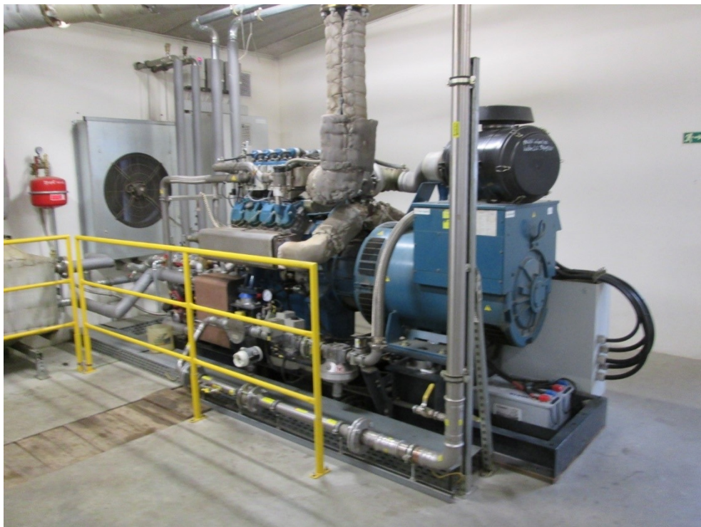
Příloha č. 4 Motor kogenerační jednotky
