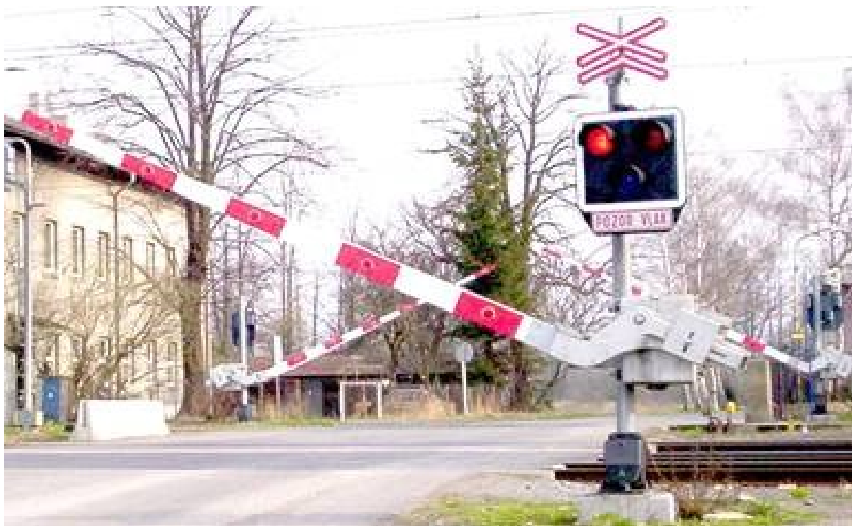
OBRÁZEK 2: VÝSTRAŽNÍK AŽD 97 – PV V PROVOZU [4]
