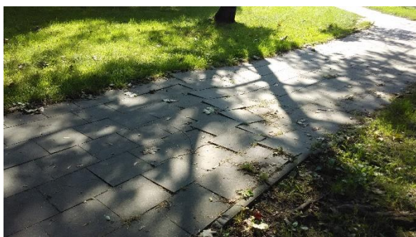
Obr. 4 Fotografie nerovnosti povrchu chodníku
