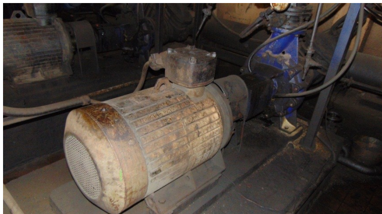
Obr. 73 Čerpadlo 8B [Autor]
