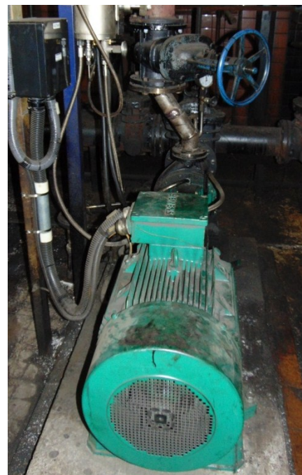
Obr. 148 Čerpadlo 7b [Autor]
