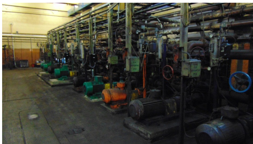
Obr. 32 Strojovna separace benzolu [Autor]
