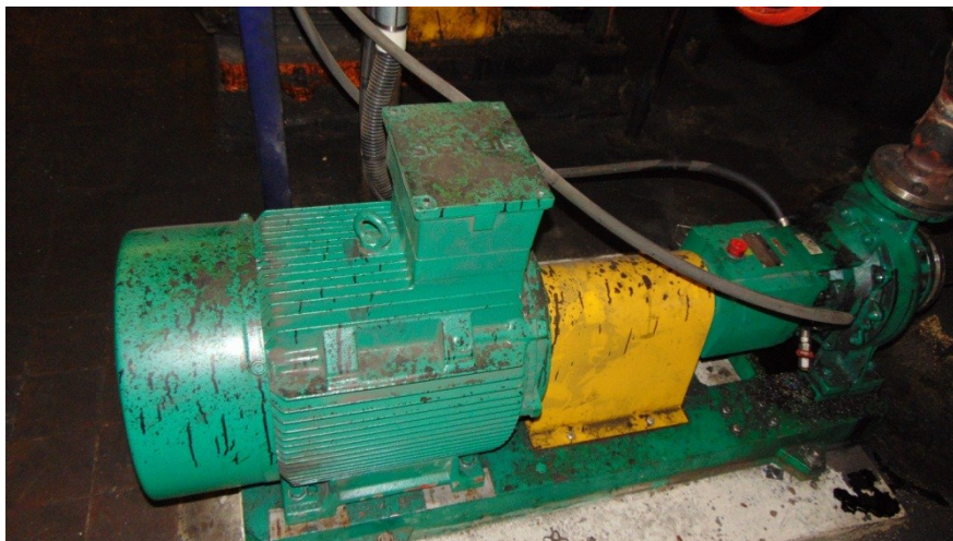
Obr. 164 Čerpadlo 9b [Autor]
