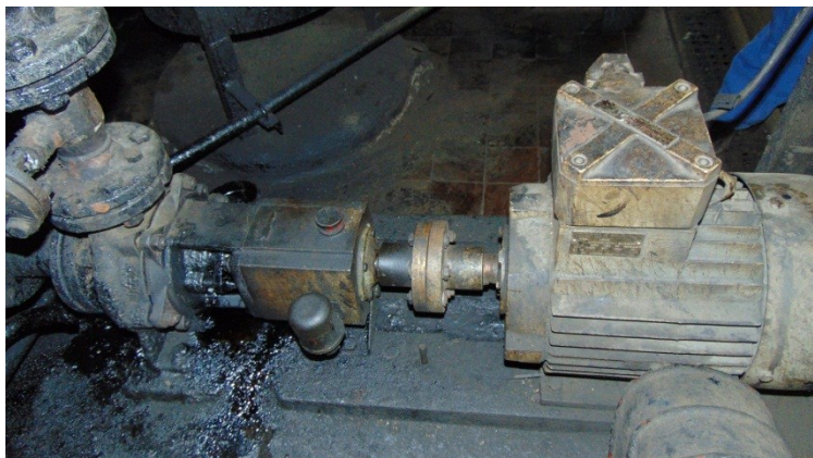
Obr. 85 Čerpadlo 9B [Autor]
