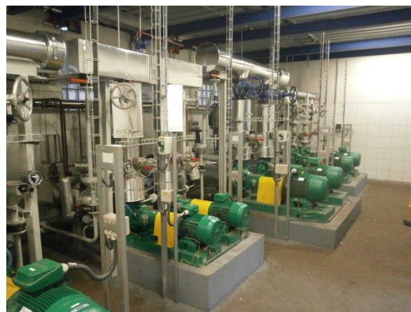
Obr. 31 Nově vybudovaná strojovna [Autor]
