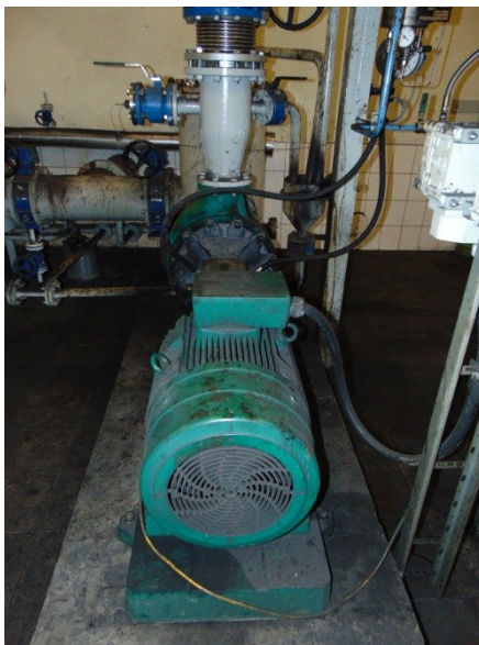
Obr. 33 Čerpadlo čpavkové vody 09b [Autor]
