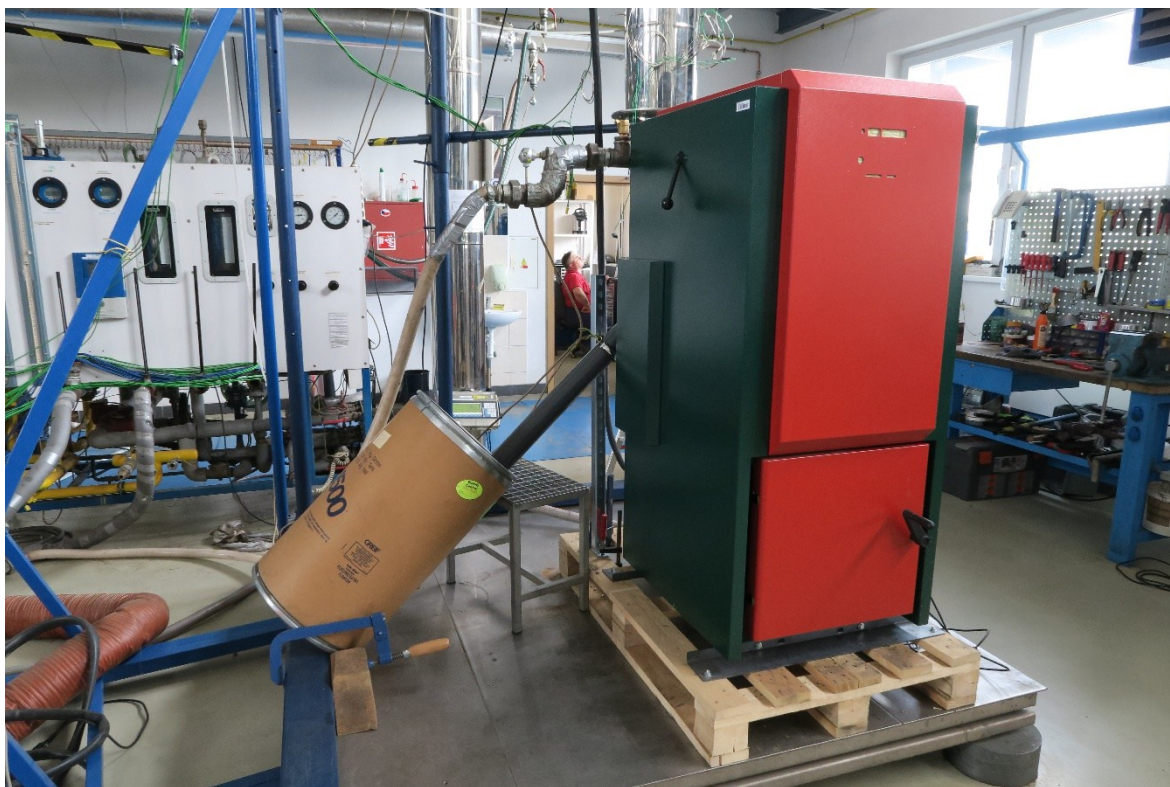
Obr. č. 5.6 Kotel Ponast KP21 použitý pro testování nového hořáku
