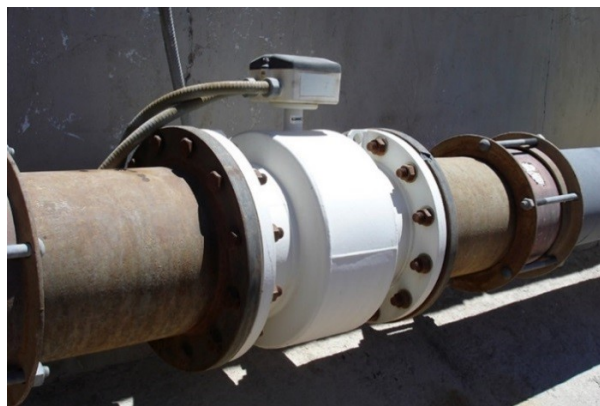
Obr. 17 Indukční průtokoměr v praxi [18]
