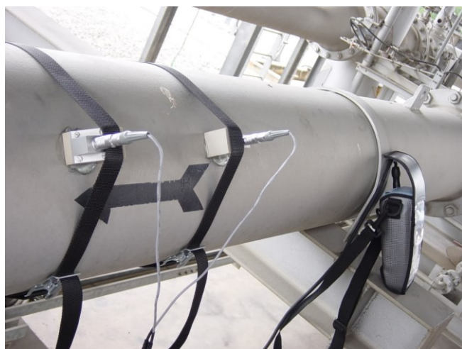
Obr. 18 Indukční průtokoměr v praxi [19]
