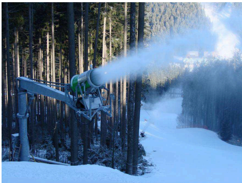
Obr. 6 Zasněžovací systém SUFAG
