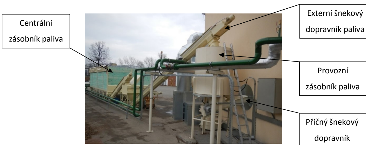
Obr. 2 - Doprava paliva do prostoru kotelny.
