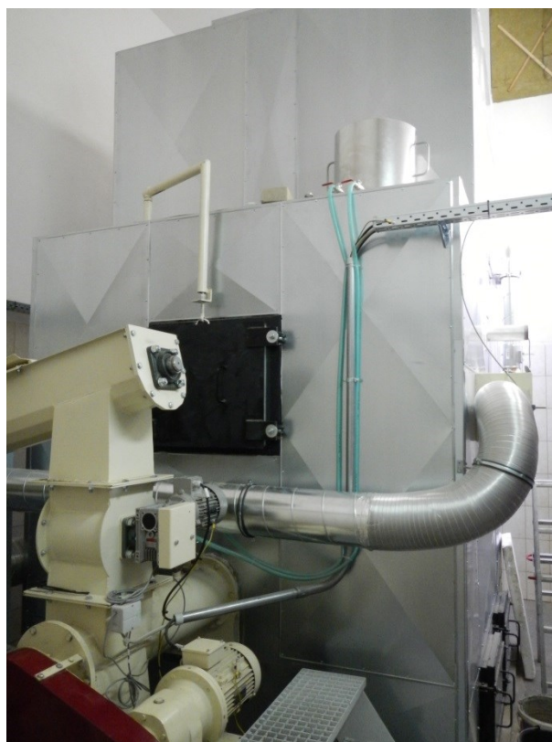
Obr. 6 - Kotel na spalování dřevní štěpky.
