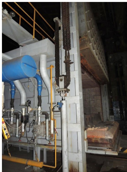
Obr. 5.14 Pohled na pohon vrat dveří, hydroválec [Vlastní foto]
