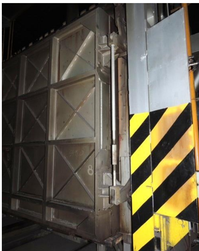
Obr. 5.12 Celkový pohled na pákový mechanismus pro uzavření dveří [Vlastní foto]
