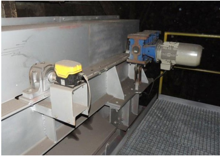
Obr. 5.7 Elektromotor s převodovou skříní na vrchní rampě pece, zezadu [Vlastní foto]
