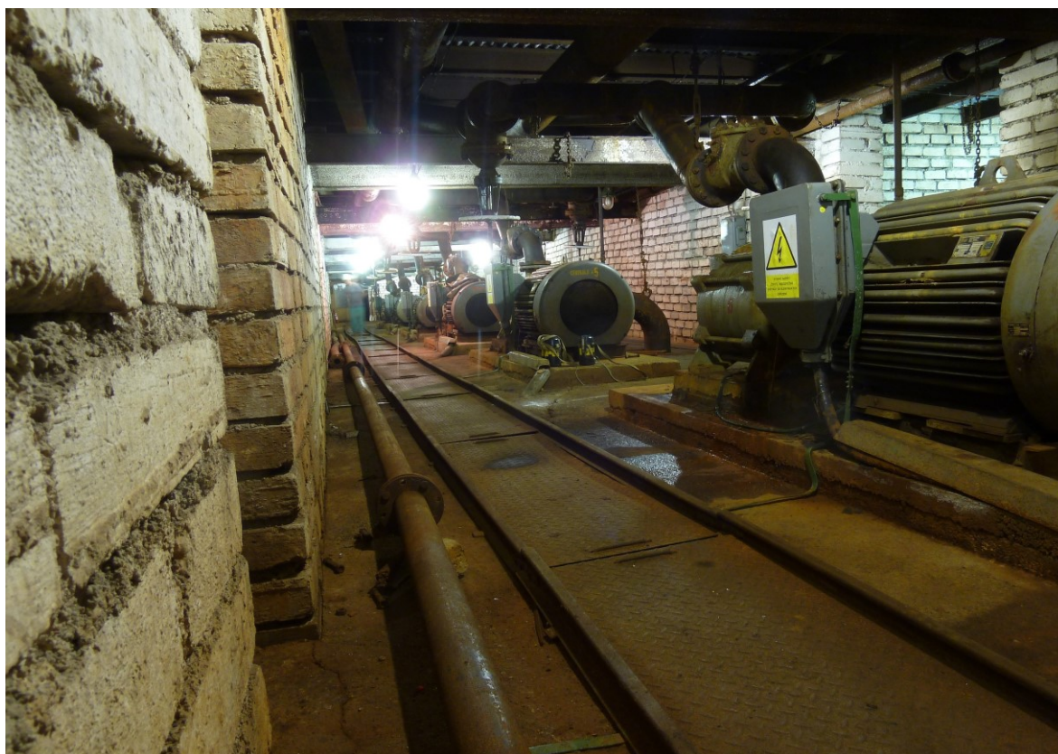
Obrázek 10: Původní hlavní čerpací stanice na dole Marie II. Zdroj: archiv P. Šeda
