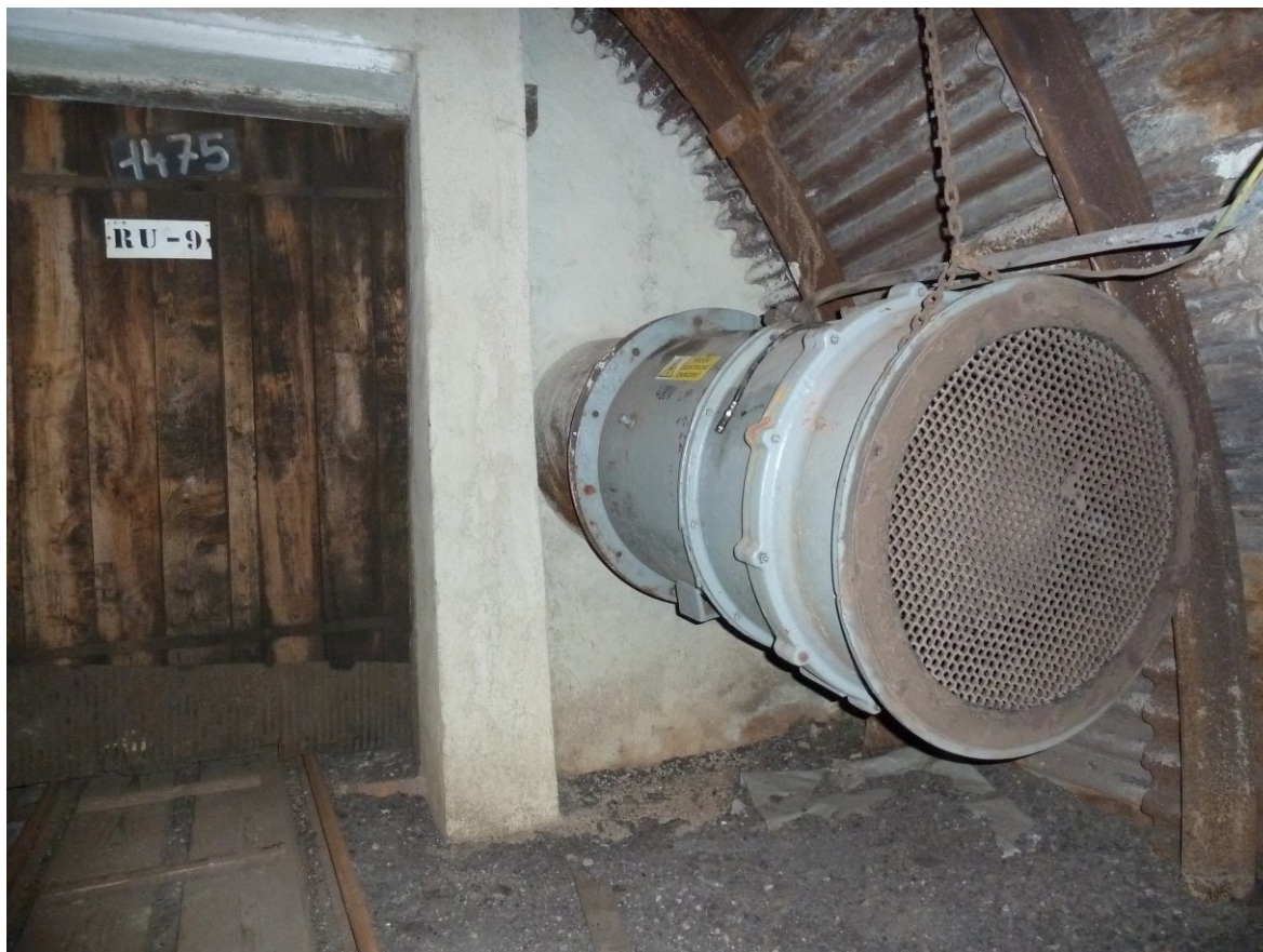
Obrázek 3: Umístění hlavního ventilátoru ve štole C11. Zdroj archiv P. Šeda
