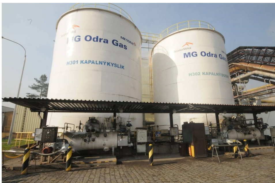
Obrázek č. 4: MG Odra Gas, spol. s r.o. kyslíkárna (foto Zielinski).
