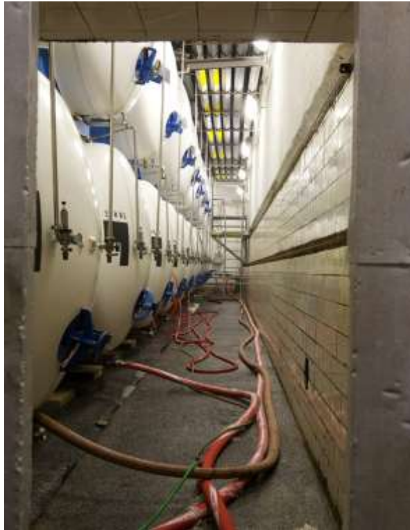
Obr. 3.1 Ležácké tanky v ležáckém sklepeř pivovaru Ostravar
