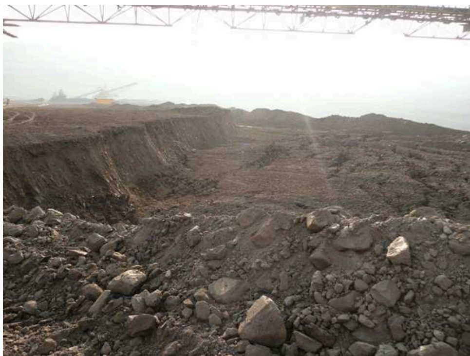
Obr. 4: Pokles na výsypkové etáži, projev lokální nestability výsypky na lomu Bílina r. 2013 (Severočeské doly a.s.)
