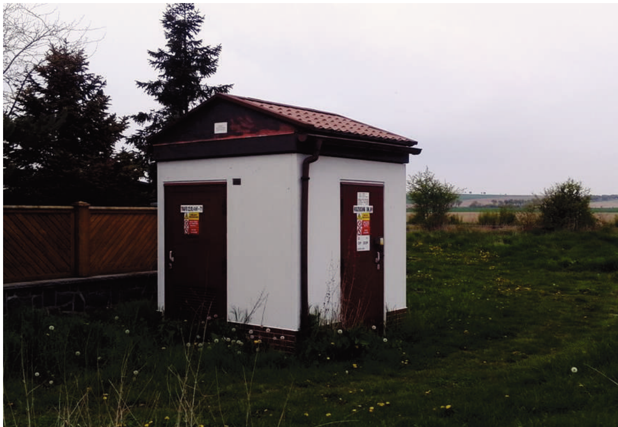
(Obr.8 Pohled na trafostanici v severní části území, autor Petra Kocurová)
