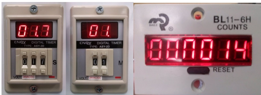
Obrázek 8.23: Ověření funkčnosti časových relé a čítače
