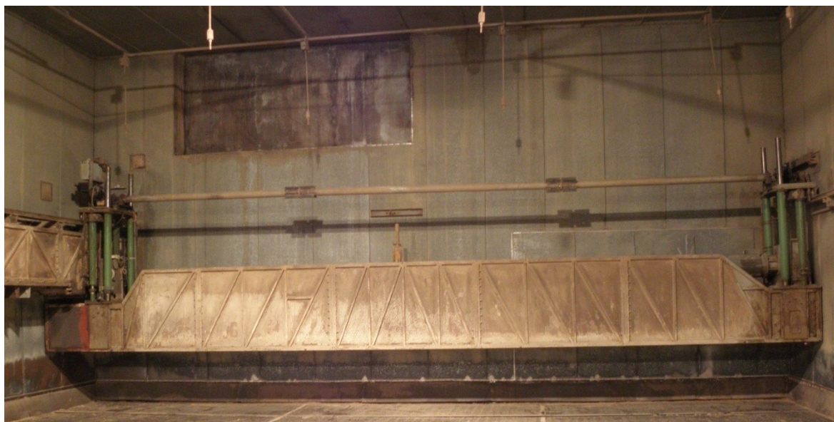
Obr. 7. Stávající nastírací zařízení [18]
