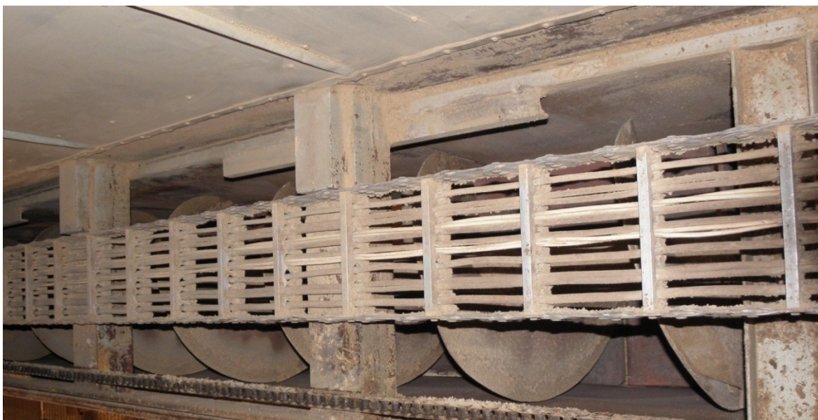
Obr. 10. Dopravník zásobující nastírací zařízení [18]
