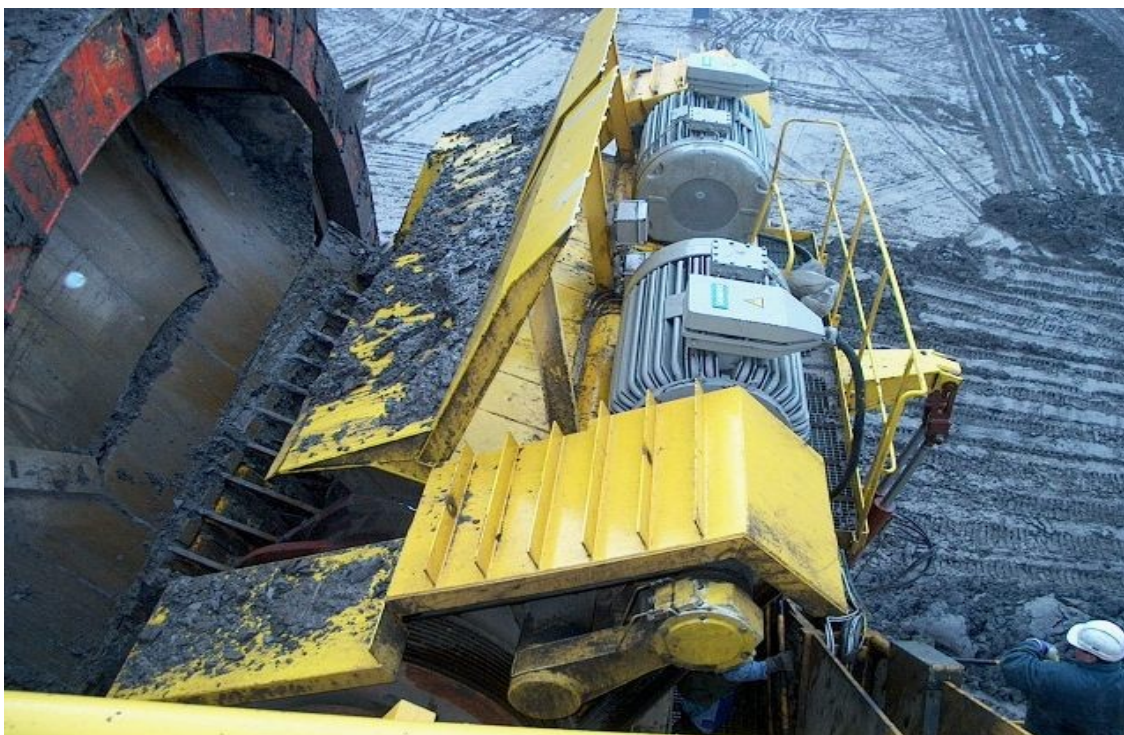
Obrázek 22 – Pohled na zakrytování rotoru, hnací a hnané řemenice s řemeny a na hnací elektromotory
