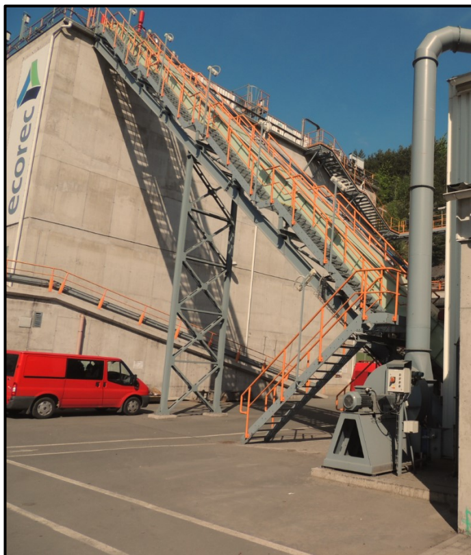
obr. 2.5 – zavážecí redleru do skladovacího FSL boxu
