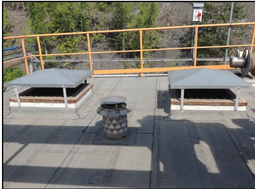
obr. 4.1 – pohled na odvětrávací otvory umístěné na střeše FSL boxů v celkovém počtu 8ks
