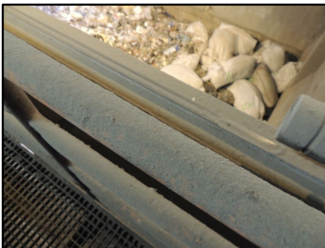
obr. 4.2 – sediment prachu na zábradlí u pochozí lávky v skladu nedrceného odpadu
