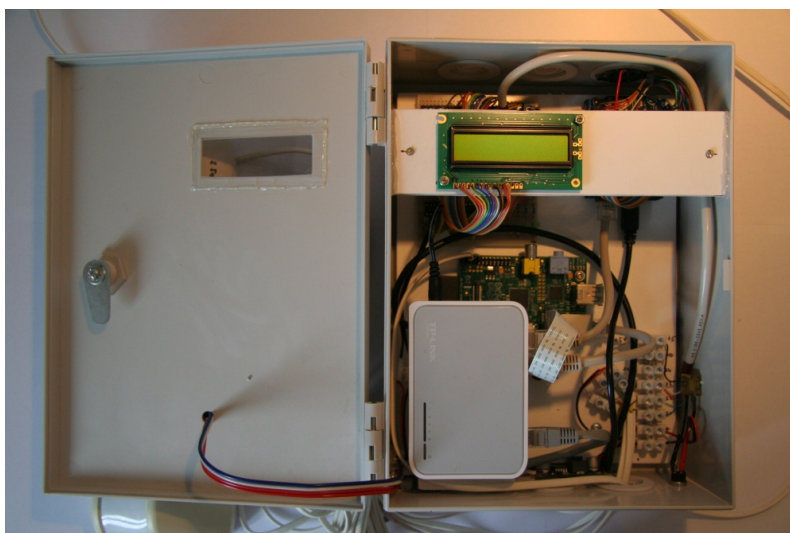
Obrázek 3.14: EZS umístěn v rozvaděčové skříni
