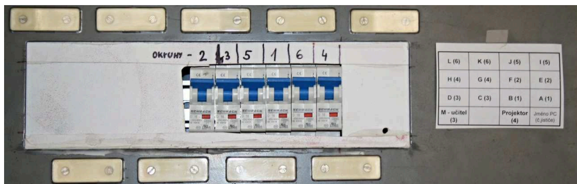
Obr. 5 – jističe v rozvaděči v učebně PorE104
