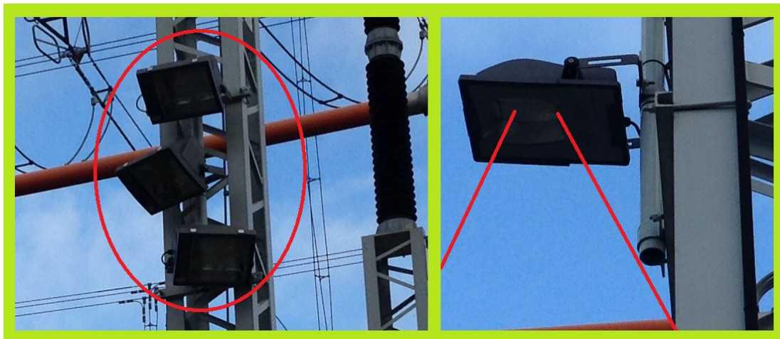
Obrázek 2.2 – Osvětlení rozvodny Kletné
