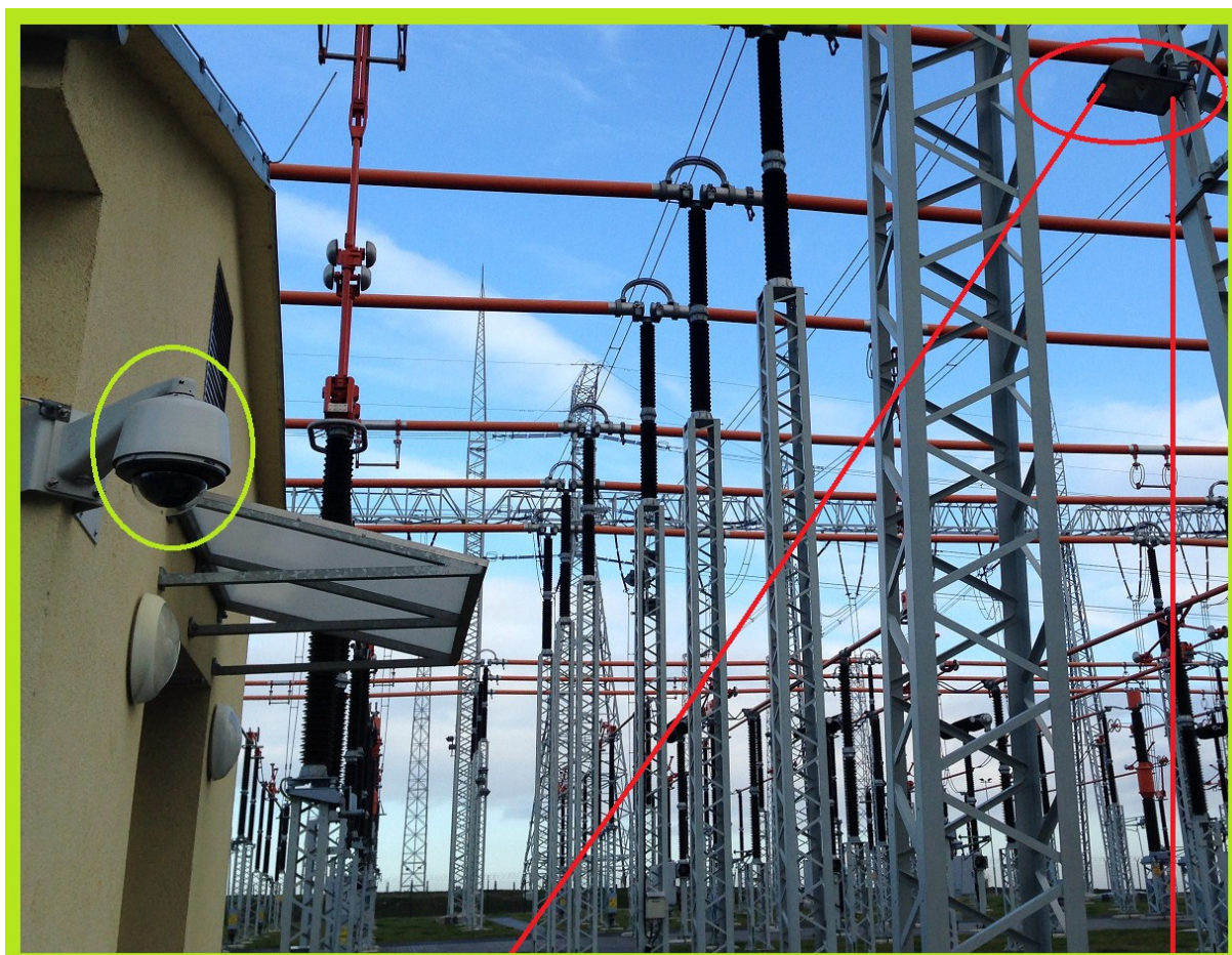
Obrázek 2.3 – Ukázka správného nasměrování osvětlení rozvodny Kletné
