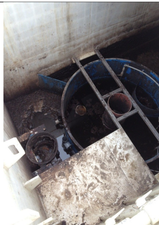
Obrázek 11 Pohled 2 do interiéru ČOV [26]
