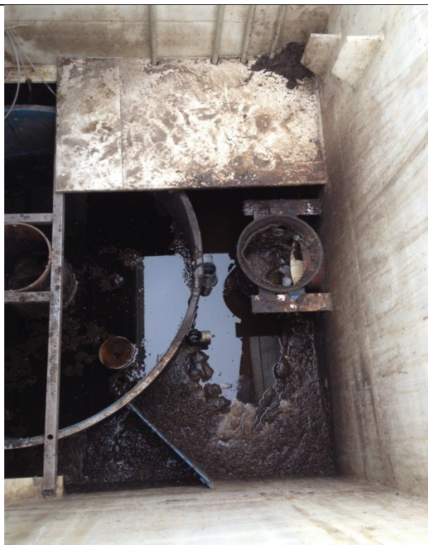
Obrázek 10 Pohled 1 do interiéru ČOV [26]
