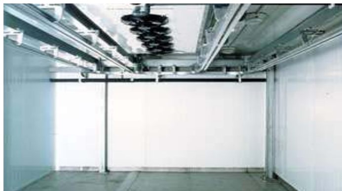
Figura 45. Fotografía de cuarto frío parte interna
