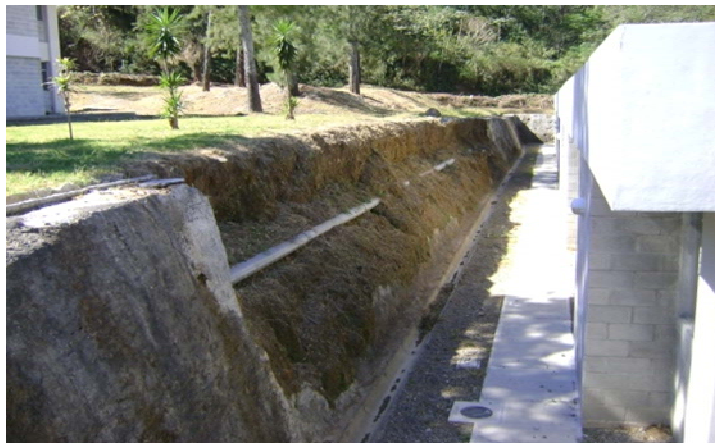
Figura 72. Fotografía de taludes inestables
