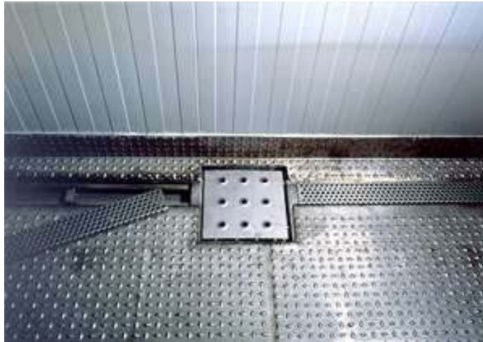
Figura 29. Fotografía de instalación desagüe
