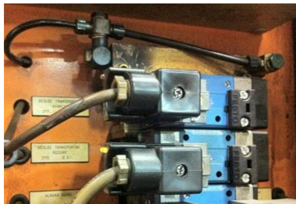
Figura 61: Eletroválvulas responsáveis pelo movimento do transportador
