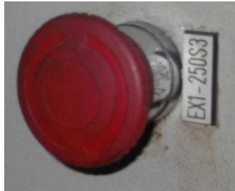
Figura 53: Exemplo de um botão de emergência
