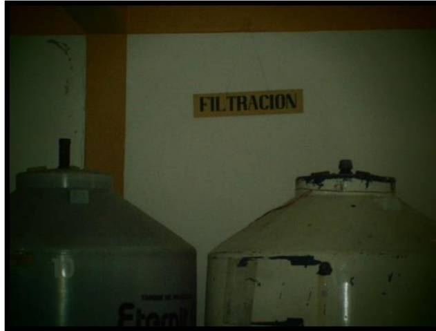
Imagen N° 14: Zona de Filtración
