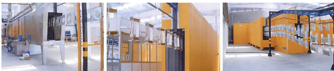
Figura 33 - Túnel de Lavagem; Túnel de Secagem; Forno
