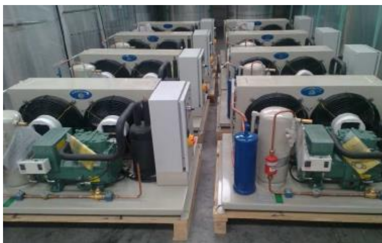
Figura 34 - Grupo de condensação Centauro com quadro eléctrico
