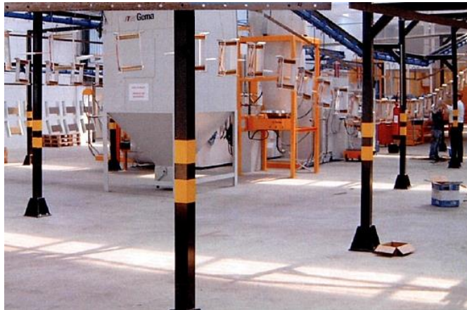
Figura 32 - Instalação de pintura electrostática a pó
