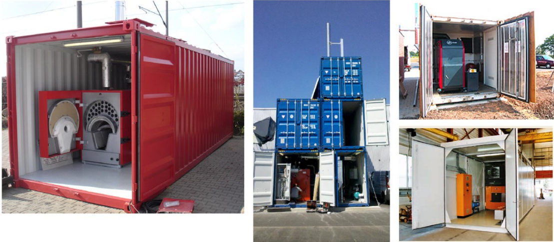
Kuva 20. Erilaisia kontteja ja niihin asennettuja lämpölaitoksia. (Schmid energy solutions 2017, A.P. Bioenergietechnik GmbH 2016, Satabio Oy 2017b)
