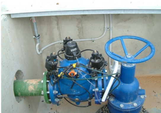
Figura 52 – Automatização de hidrantes
