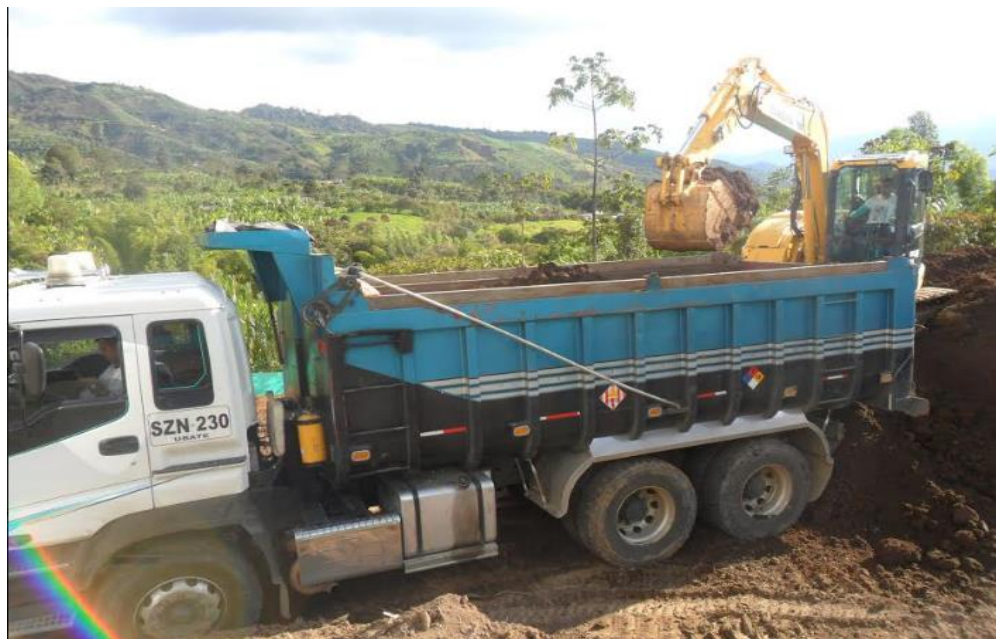
Figura 7: volquetas doble troque 6x4
