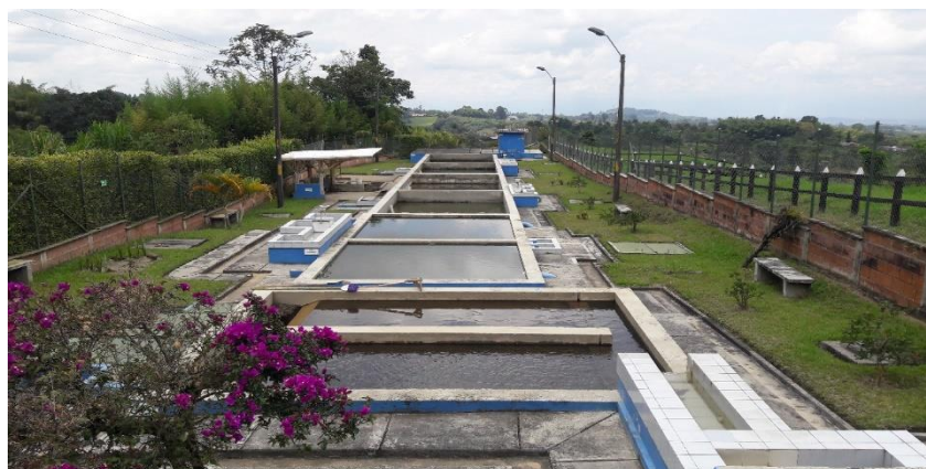
Fotografía 3: Planta de tratamiento
