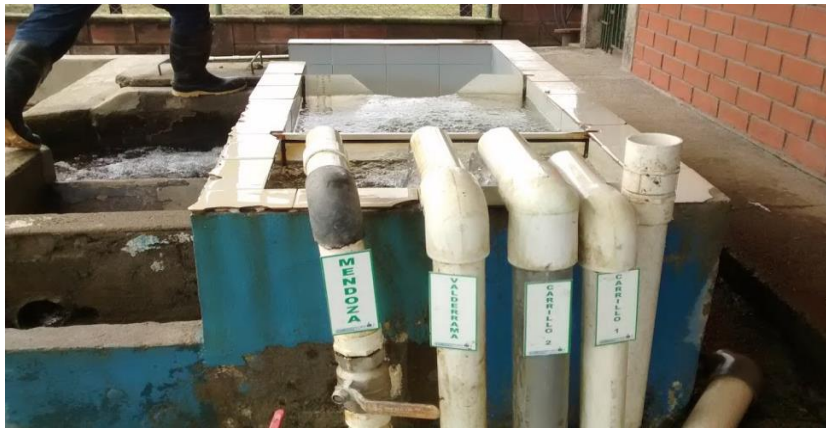
Fotografía 1: Entrada de las 4 bocatomas a la planta.
