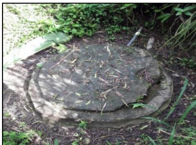
D. Aljibe con grietas
