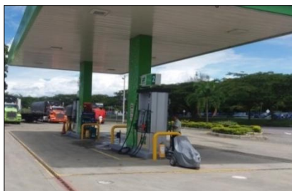
A. Pozos de monitoreo de fugas de combustible en E.D.S
