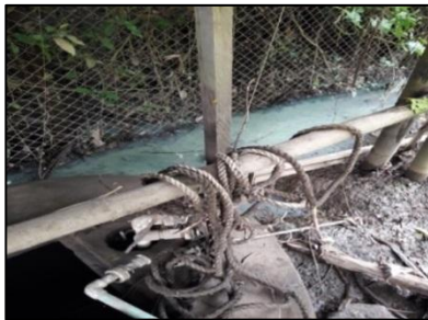
A. Acumulación de aguas lluvias y lixiviados
