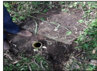
C. Tubo de aireación sin protección
