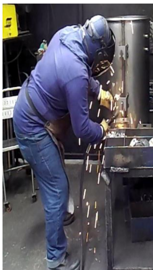
Imagen 29. Puesto 5 .Punteado de piezas externas. Posicionamiento y soldadura de pieza 7 (Fuente propia)
