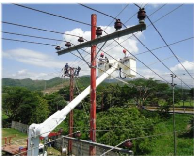
Figura 8. Redes de distribución
